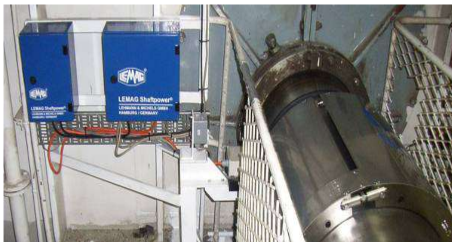
Рисунок 1.9 – Секція валолінії з встановленими датчиками положення
