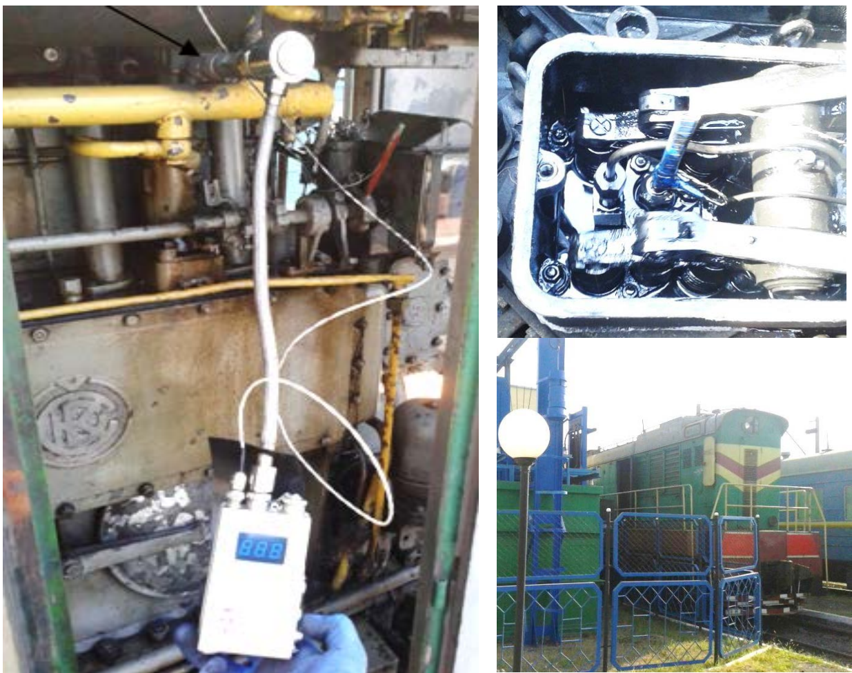
Рис. 5. Передремонтна діагностика тепловозного дизеля K6S310DR на станції реостатних випробувань в локомотивному депо № 1, Одеса-Сортувальна
