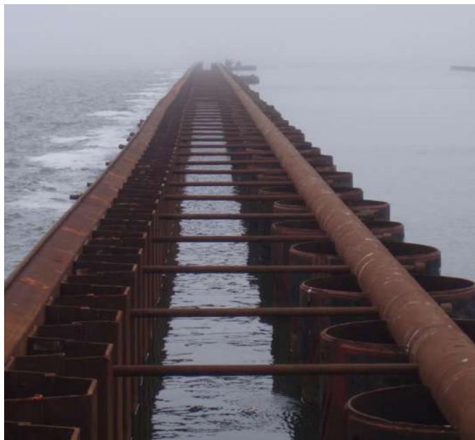
Рис. 1.7. Застосування шпунтових палей коритного профілю типу PU 32 при зведенні причалів №19 і 20 ТОВ «Трансінвестсервіс» компанією ТОВ «Мьобіус Констракшн Юкрейн» в 2008 р. (порт Южний)
