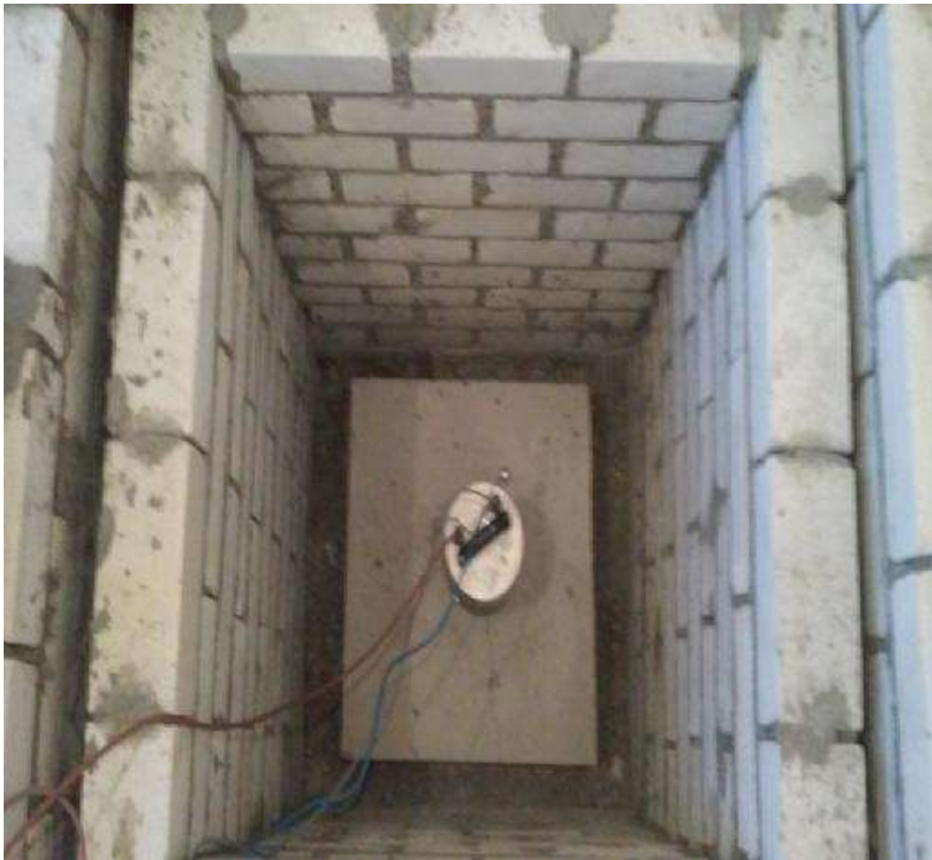
Рис. 2.25 Загальний вид сеймостанції «Одеса-Місто» в ОНМУ.
