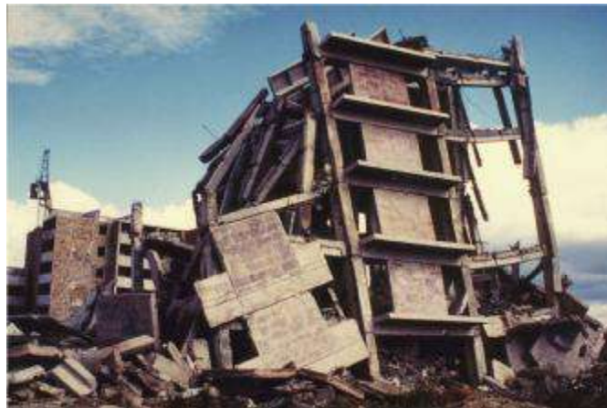
Рис. 0.8. Руйнування залізобетонного каркасного будинку серії 111 (пошкодження 5-го ступеня) і стан крупнопанельного житлового будинку
