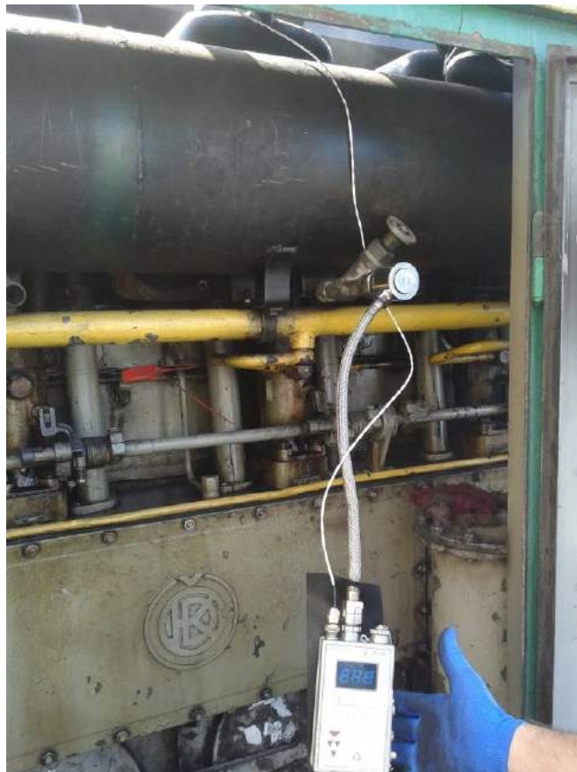
Рис. 4.4 – Установка датчика тиску PS-20m на індикаторний кран
