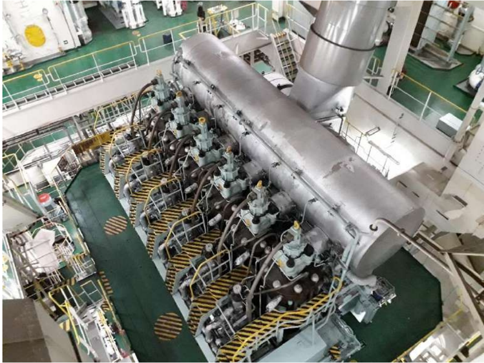
Рис. 4.25 – ГД MAN B&W 6S70MC-C.8.1 встановлений на балкері capesize “FMG GRACE”
