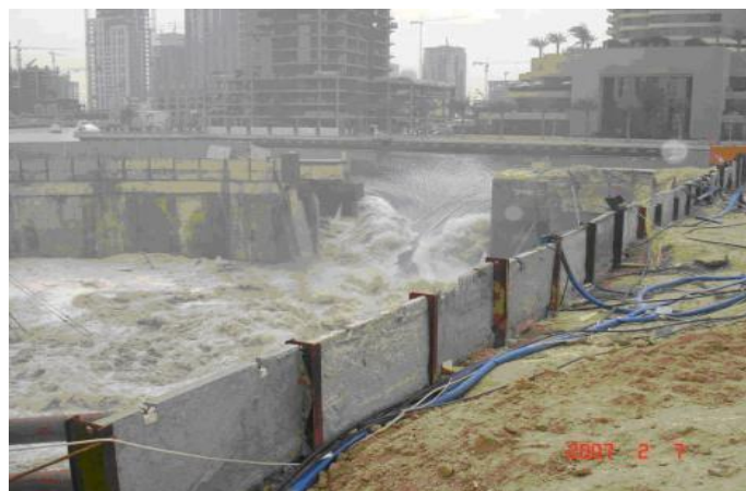
Рисунок 1.4. Обвалення стінки котловану в Загребі (2007 р.)
