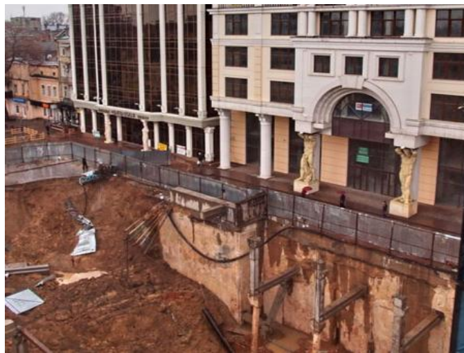
Рисунок 1.3. Обвалення стінок котловану на Грецькій площі в Одесі
